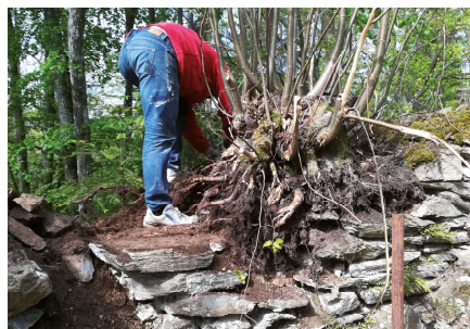
Je nutné odstranit ráčkové dřeviny, které narušují stabilitu a celistvost zdiva hradu
